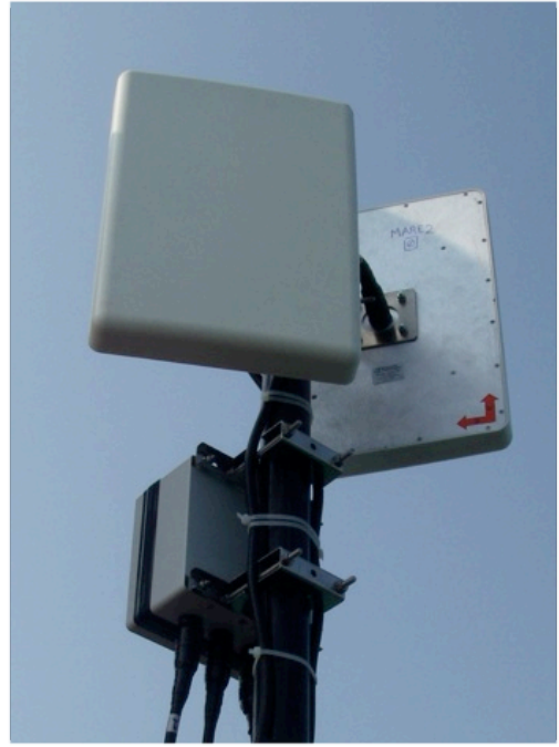
antenas de panel
